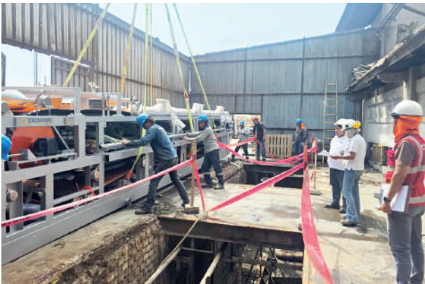
DESCARGA DE FILTRO DE BANDA PARA CACHAZA.
