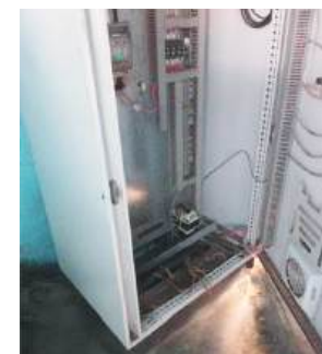
ROBAN EQUIPOS EN POZO N.º 1 DE OYOTÚN.
