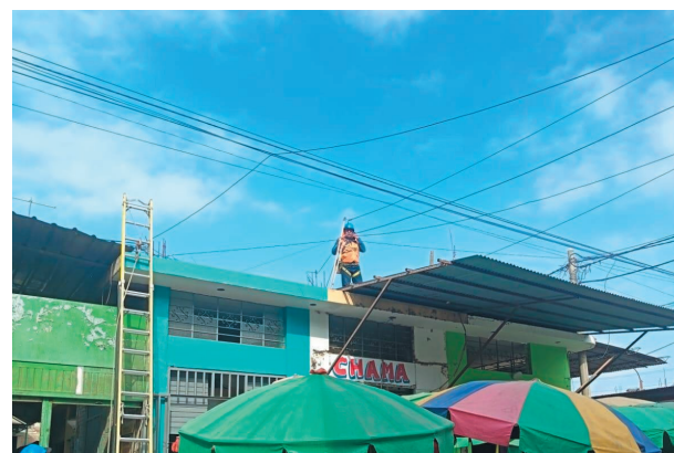
PERSONAL DE ENSA RETIRA CONEXIONES CLANDESTINAS.
