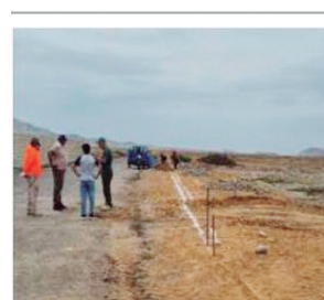
Personas ajenas a la obra venían trazando y excavando zanja al borde de la vía, ocupando parte del derecho de vía.
