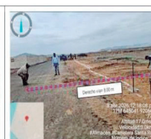
De acuerdo al Expediente Técnico el área destinada al derecho de vía es hasta 8.00m desde el eje del camino. Se aprecia que el trazo para zanja se encuentra dentro del derecho de vía.
