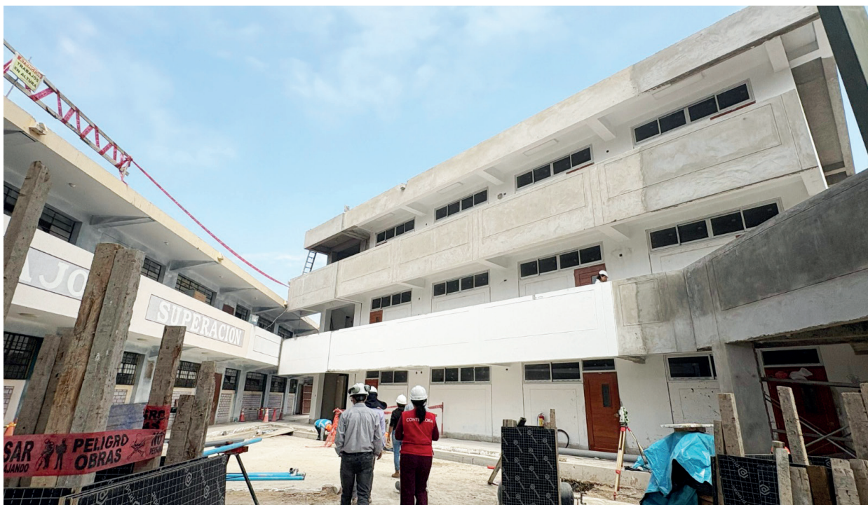
FALTA DE SUPERVISIÓN ESPECIALIZADA PONE EN RIESGO OBRA Y CUMPLIMIENTO DEL CONTRATO EN COLEGIO.
