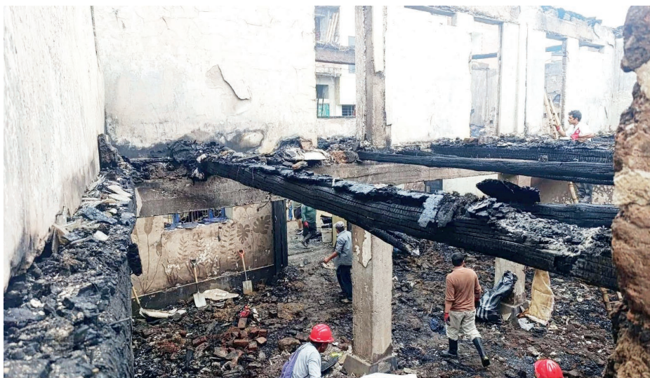
FUEGO ARRASÓ CON VIVIENDAS, UN NEGOCIO FAMILIAR Y VEHÍCULOS EN LONYA GRANDE.
