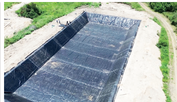
CONTRALORÍA DETECTÓ DEFICIENCIAS EN OBRAS DE RESERVORIOS.
