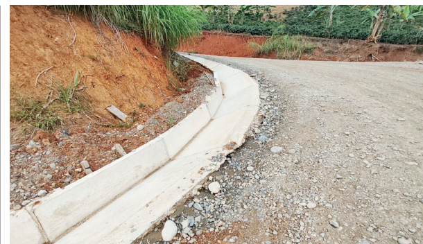
GRIETAS EN OBRA EN CAMINO VECINAL A SAN JOSÉ DEL ALTO.
