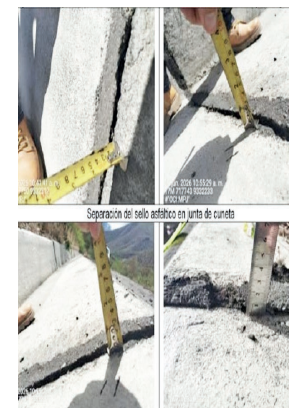
DEFICIENCIAS EN OBRA.
