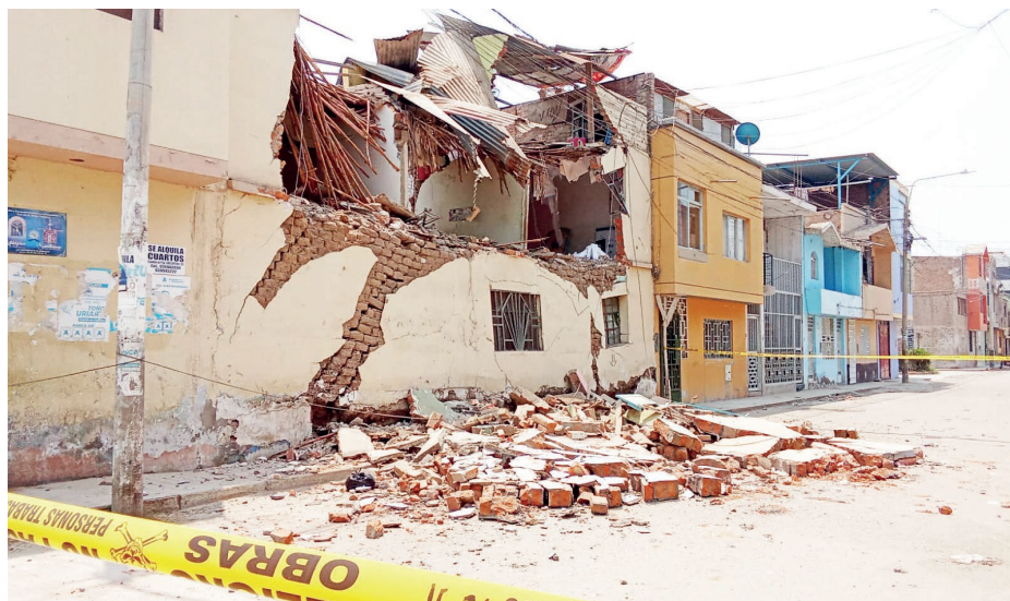
EDIFICACIONES ANTIGUAS AL BORDE DEL COLAPSO Y SON UN PELIGRO PARA TRANSEUNTES.
