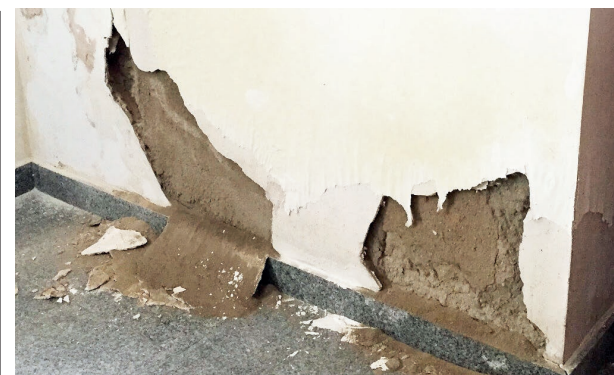
PAREDES DE VIVIENDAS PRESENTAN RAJADURAS EN EL HUITO-JAÉN.
