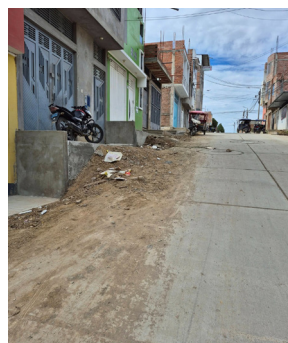
VECINOS DENUNCIAN DEFICIENCIAS EN OBRA.
